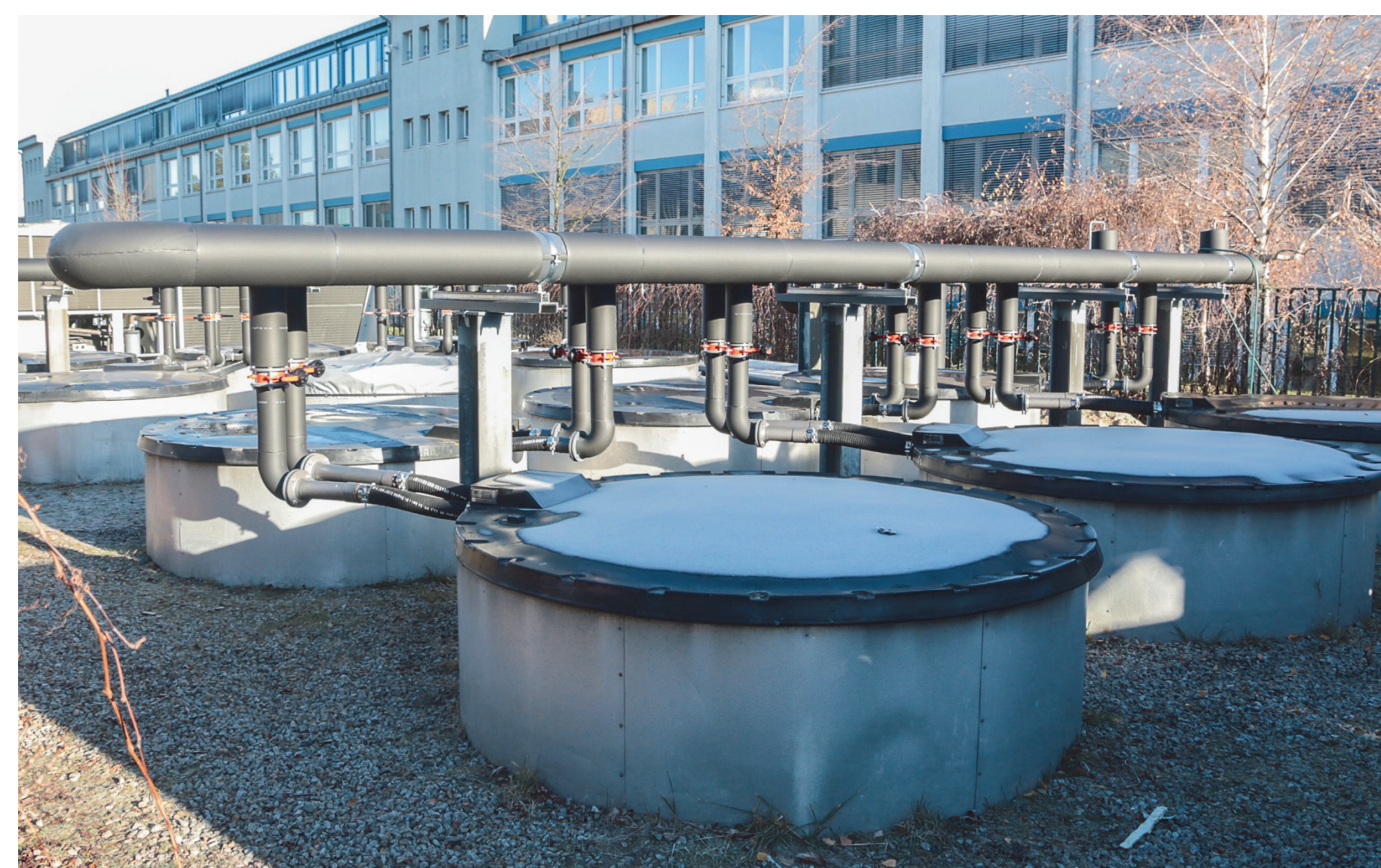
Abbildung 5 Eisspeicher in Adlershof
