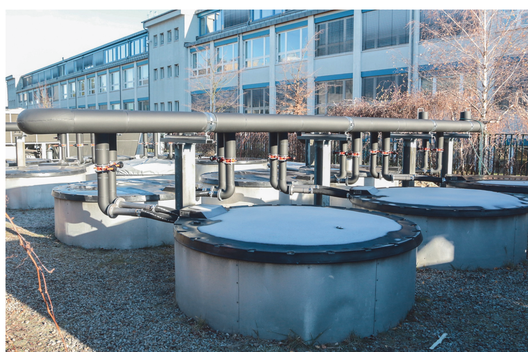
Bild 5 Eisspeicher in Adlershof
